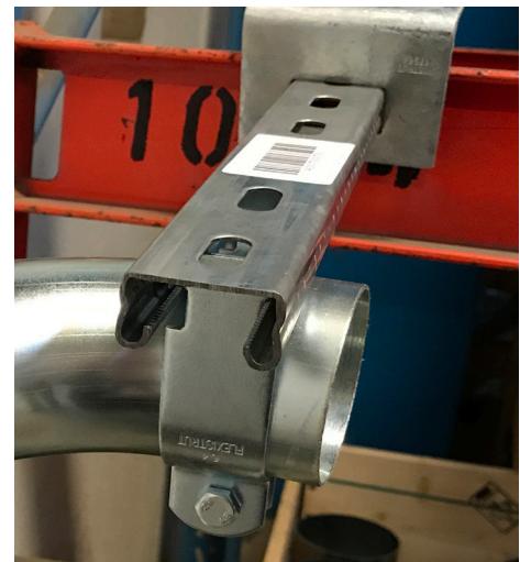
Biegung an einem Balken durch Verwendung von Rohrschelle und Trägerklemme montiert
